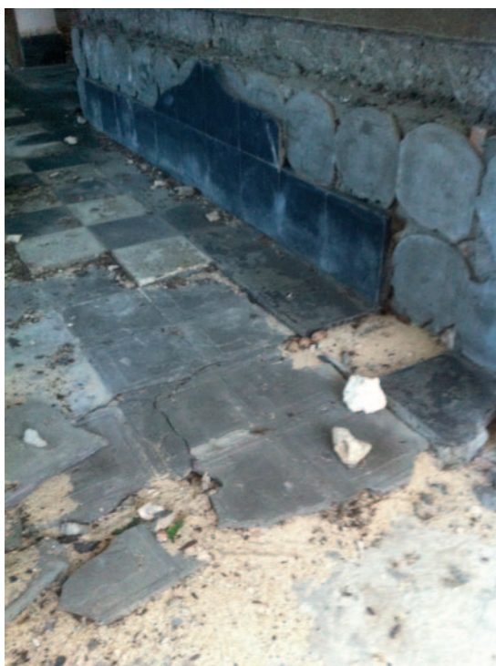
Hôtel de ville de Port Louis sur Grande-Terre en Guadeloupe (2019), les sols en céramique sont posés sur des lits de sables, cette masse est indépendante vis-à-vis de l'ossature primaire du bâtiment.
