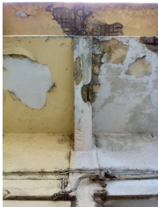
Sous face de dalle en console (balcon) du bâtiment de l'ancienne gendarmerie de La ville de Morne à l'Eau. Le bâtiment a été construit en béton, bétons armés et maçonneries dans les années 1920, environ une dizaine d'années avant le cyclone de 1928, ce bâtiment de technologies et techniques militaires est en parfait état malgré le fait d'avoir été mal entretenu et depuis des décennies. Les différentes couches de peinture étanches empêchent la perspiration des bétons et la diffusion dans l'air de l'eau d'infiltration.
